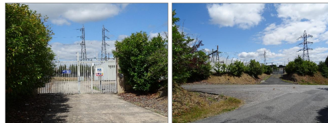
Photographie 26 : Poste source de la Seiglière (source : ENCIS Environnement)
