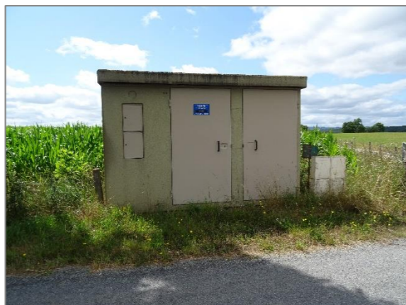
Photographie 28 : Poste électrique localisé à la pointe nord-est du site (source : ENCIS Environnement)
